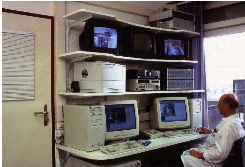
Der Telemetrie-Überwachungsraum im BHH-L Mitte
